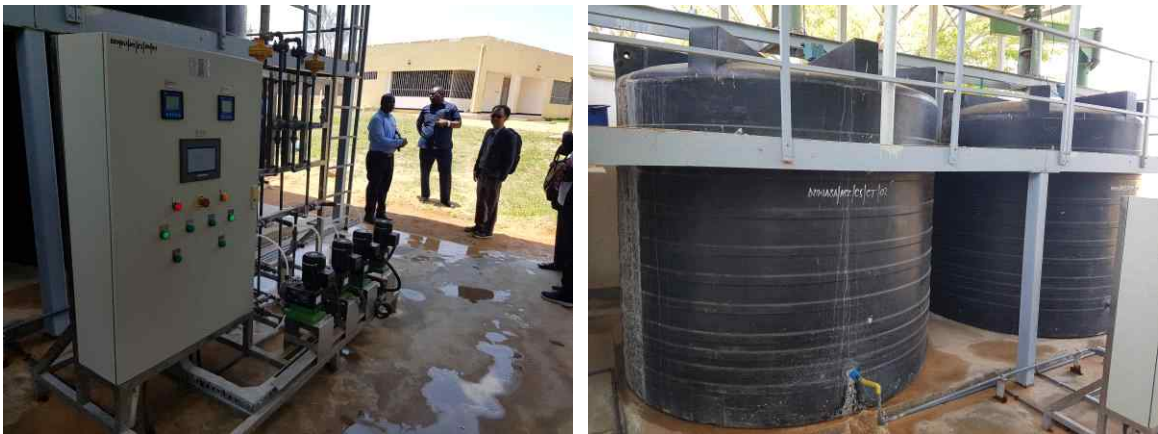
<그림 5> 염소처리시설 및 탱크
