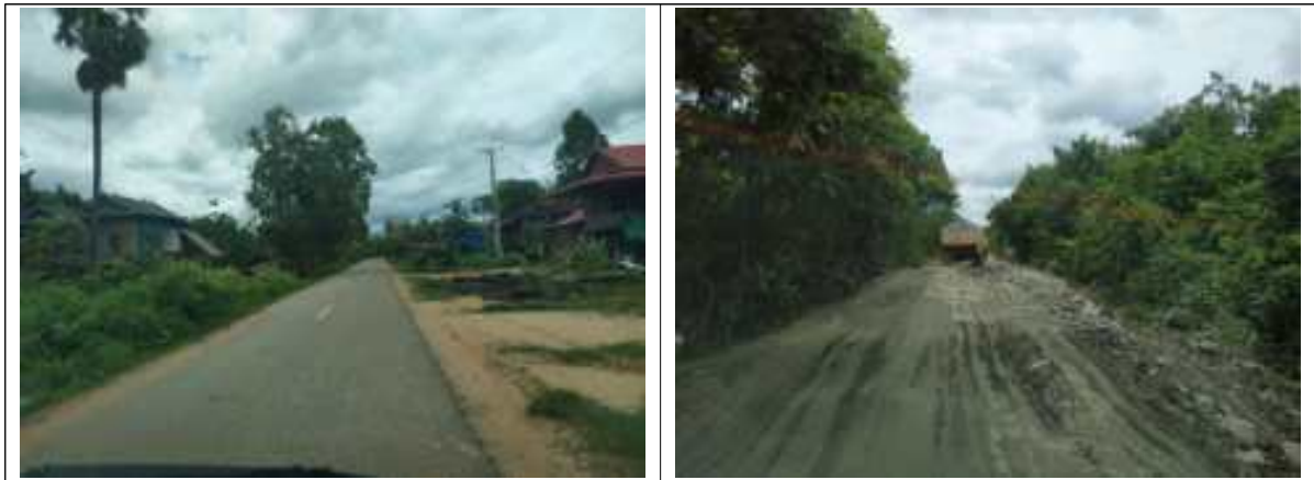
<그림 15> 종점부 포장상태 양호 구간 및 포장 전체 파손 구간
