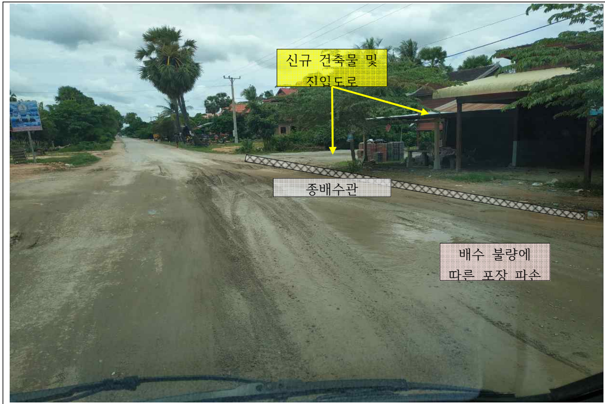
<그림 19> 건물 및 진입로 개설시 종배수관 미설치에 따른 포장 파손 현상
