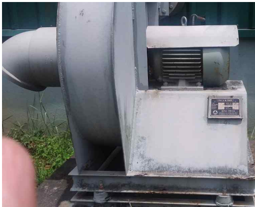
Air Blower (공기공급시설)
