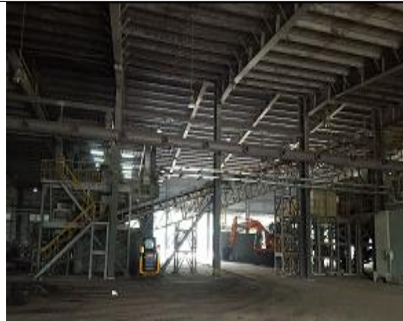
폐기물 컨베이어 벨트 이동경로
